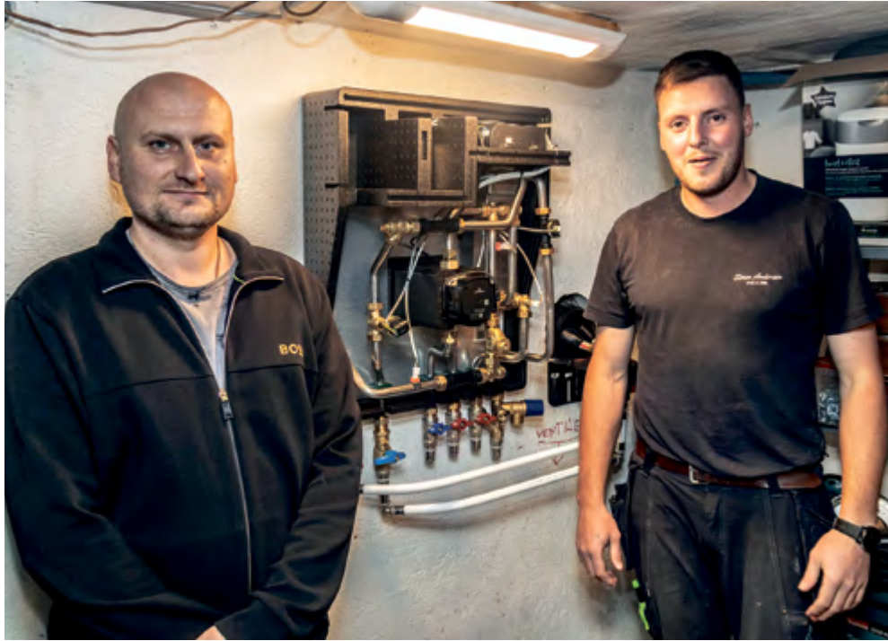
Det er Emil Andersen fra Søren Andersen VVS i Give, der har fået æren af at være den første med, der etablerer fjernvarme til et hus i Farre, Det sker hos Ewa og Piotr Jastrzębska Bak på Bakkevej 11 i Farre. Foto: Jim Hoff
