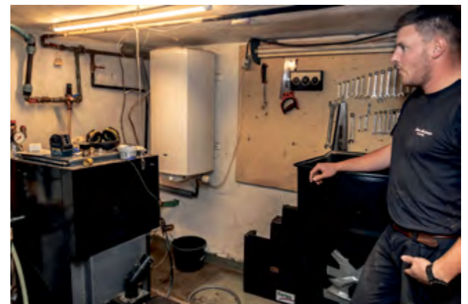
I forbindelse med etableringen af fjernvarmen til huset på Bakkevej 11, skal Emil også fjerne det gamle pillefyrr og den gamle varmtvandsbeholder. Foto: Jim Hoff
