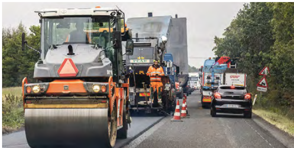
Der er godt gang i asfaltarbejdet på Diagonalvejen mellem Give og Filskov. Foto: Jim Hoff
