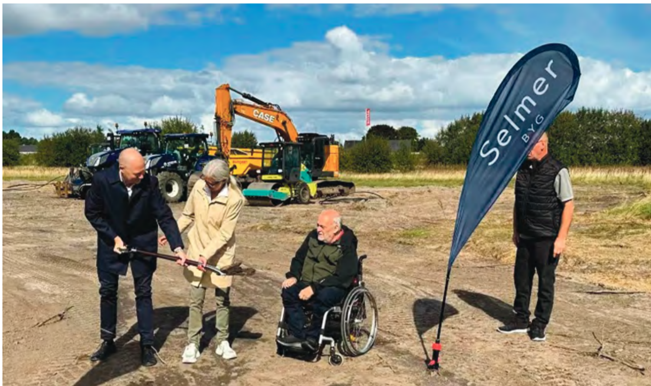
Her er det Pernille Esmark Prahm, der er projektchef hos Domea.dk, og borgmester Jens Ejner Christensen, der i fællesskab tager 1. spadestik på de 16 boliger på Gråspurvej. Foto: Jean Darly
