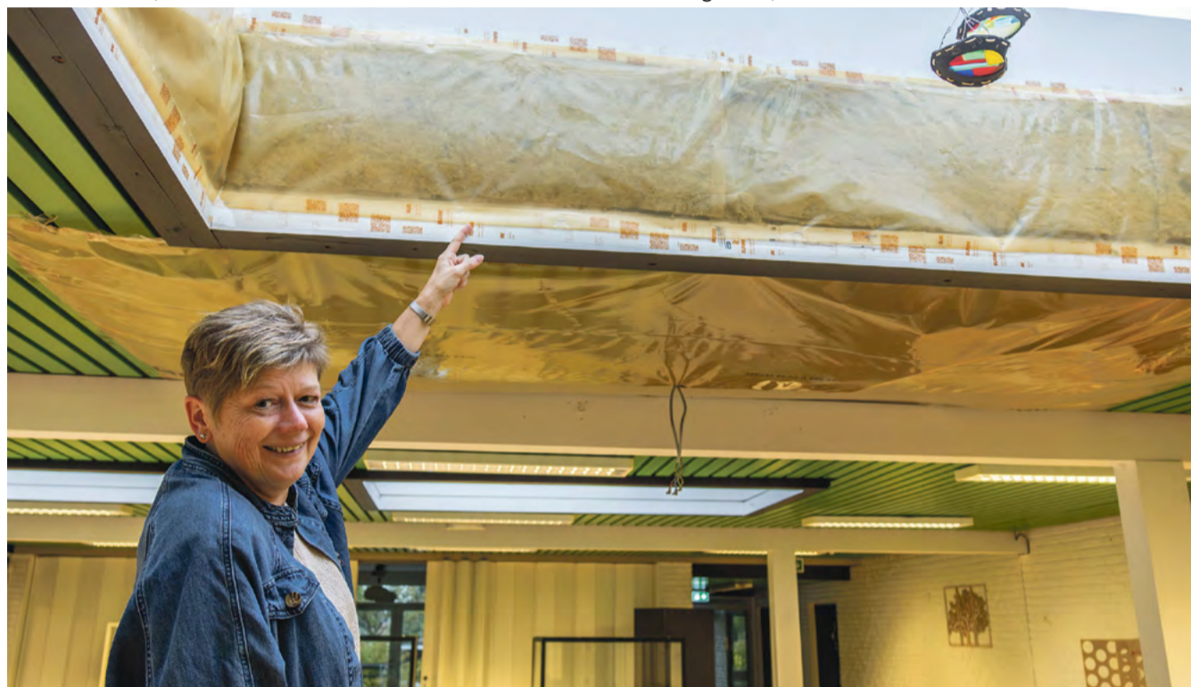
Det er ved ovenlysvinduerne i fællesrummene, som Gerda Jørgensen her viser, at problemerne med skimmelsvamp optræder. Som man kan se på billedet, er der lavet nogle interimistiske foranstaltninger, men nu kan man endelig komme problemerne definitivt til livs, efter at der er frigivet 5 millioner plus det løse til at få løst udfordringerne. Foto: Jim Hoff
